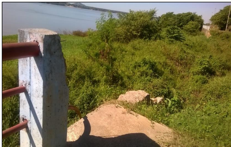
Figura 14. Obra mal estruturada no Beiradeiro.
